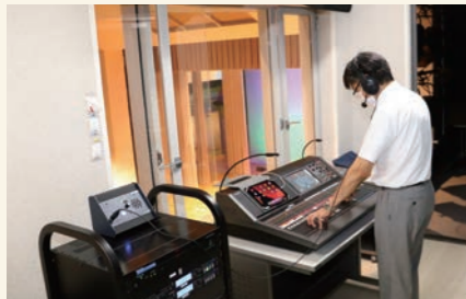
ラピア鹿島ホール音響設備更新
