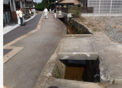
末坂地内 溝に蓋が無いため危険
