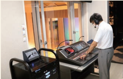
ラピア鹿島ホール音響設備更新
